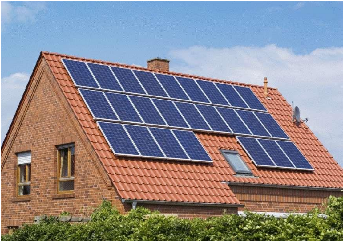
Рисунок 1.2 - Приклад встановлення сонячних панелей на будинках [16]
